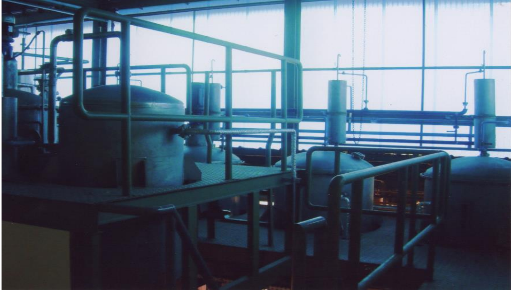
Gambar 2 Unit Reaktor Transesterifikasi untuk Produksi Biodiesel LEMIGAS (Sumber: Dokumentasi Koleksi Oberlin Sidjabat)
