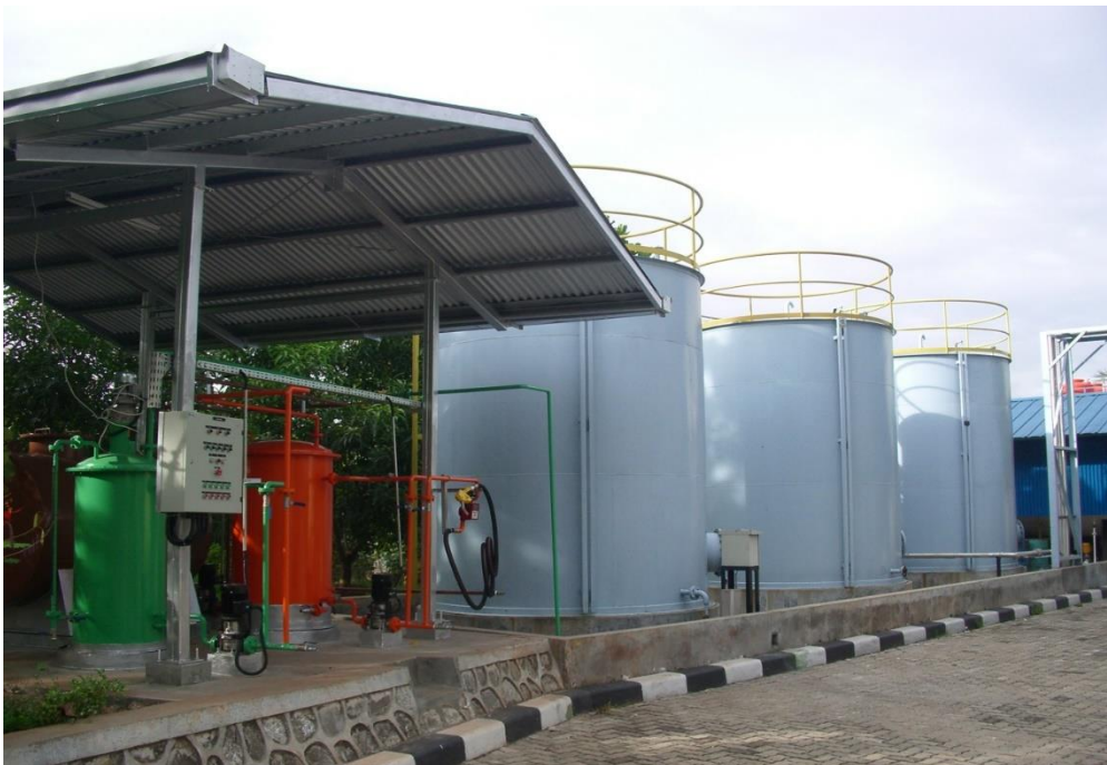
Gambar 3 Unit Blending (bagian kiri) dan Tangki Storage Biodiesel dan Bahan Baku (bagian kanan) (Sumber: Dokumentasi Koleksi Oberlin Sidjabat)
