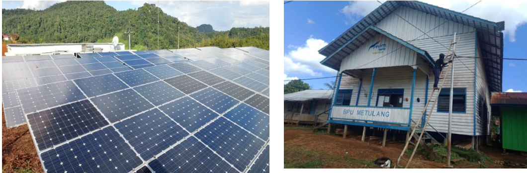
Gambar 3.20 Revitalisasi PLTS Desa Long Ampung, Kabupaten Malinau
