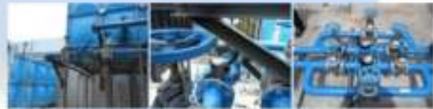
FIGURE 23 Penempatan Sub Metering
